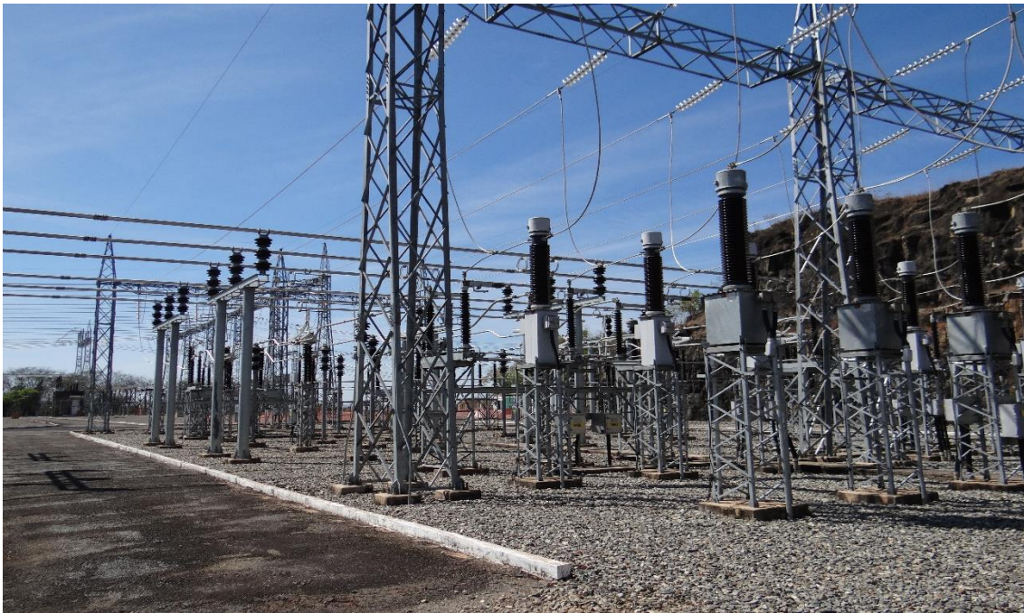
Figura 1. Foto pátio de 500kV da subestação de Emborcação (Fonte: Autor)
